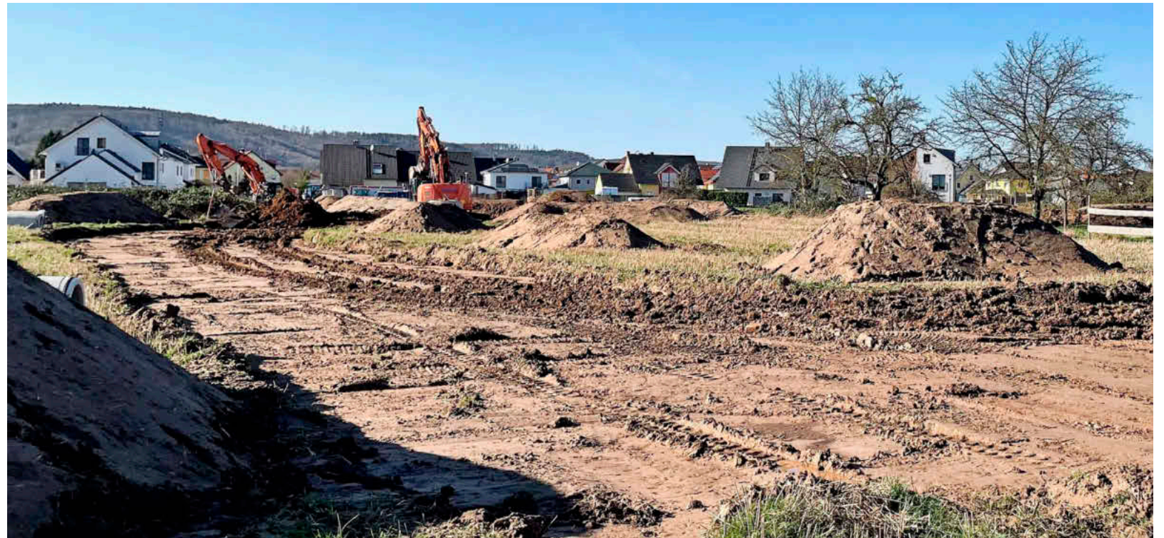
Die Arbeiten im Baugebiet »Südlich Hofstetter Straße V« in Kleinwallstadt haben begonnen – ganz ohne offiziellen ersten Spatenstich.
