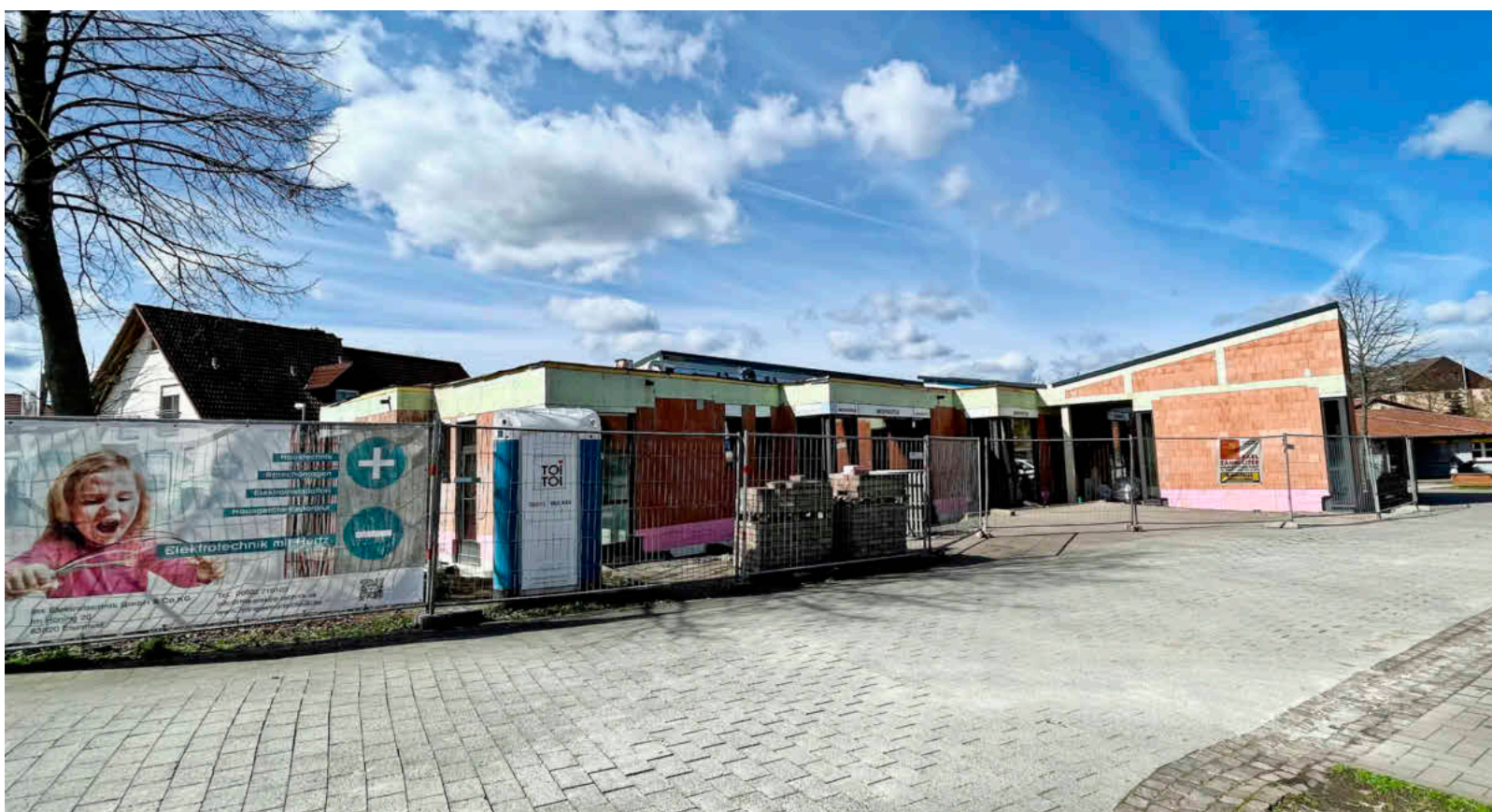
Größter Kostenfaktor: Der Bau der Kinderkrippe in Kleinwallstadt ist im Zeitplan, sodass der Inbetriebnahme zum neuen Kindergartenjahr nichts im Wege steht. Foto: Christel Ney
